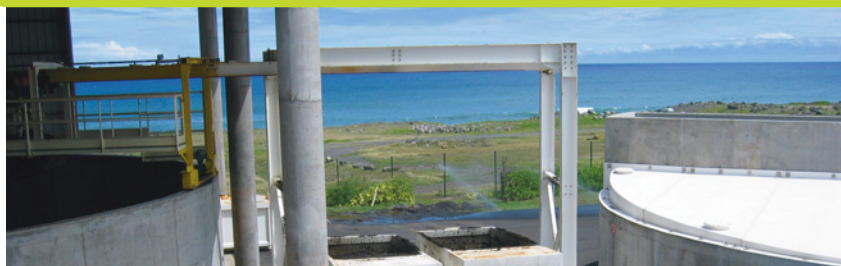
Fosse de séchage et conteneur de boues pour le chargement (Saint-Pierre). © V. van de Kerchove
